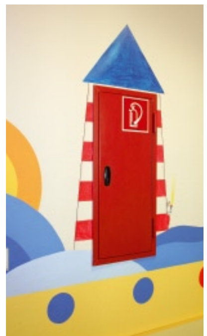
Sogar der Feuerlöscher übernimmt beim Farbkonzept eine tragende Rolle
